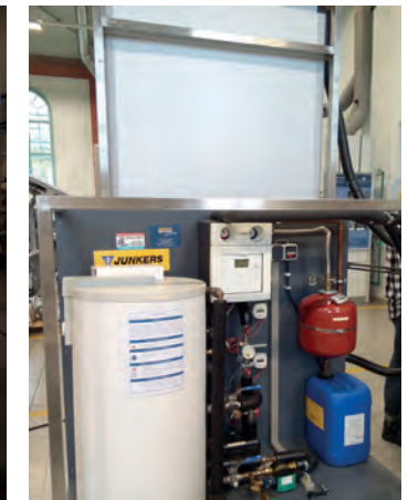
Abbildung 4: Kollektorrückseite, Warmwasserspeicher, Wärmetauscher und Ausdehnungsgefäß
